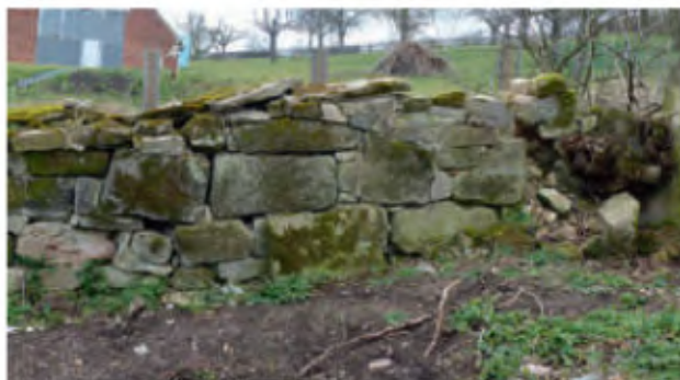
So sah die Mauer vorher aus
